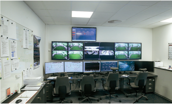
I kontrollrommet i anlegget har driftsoperatørene full oversikt over det som skjer i karene med fisk.
