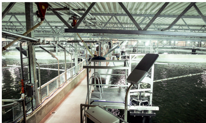
Fra hallen med åtte identiske kar i det nyeste anlegget. Det er 2.300 kubikkmeter vann i hvert kar.
